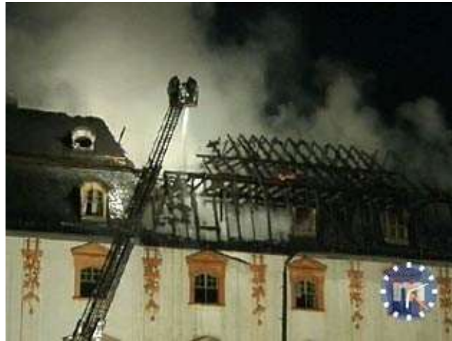
Bild 1 Gebäudeschaden beim Brand in der Herzogin Anna Amalia-Bibliothek in Weimar
