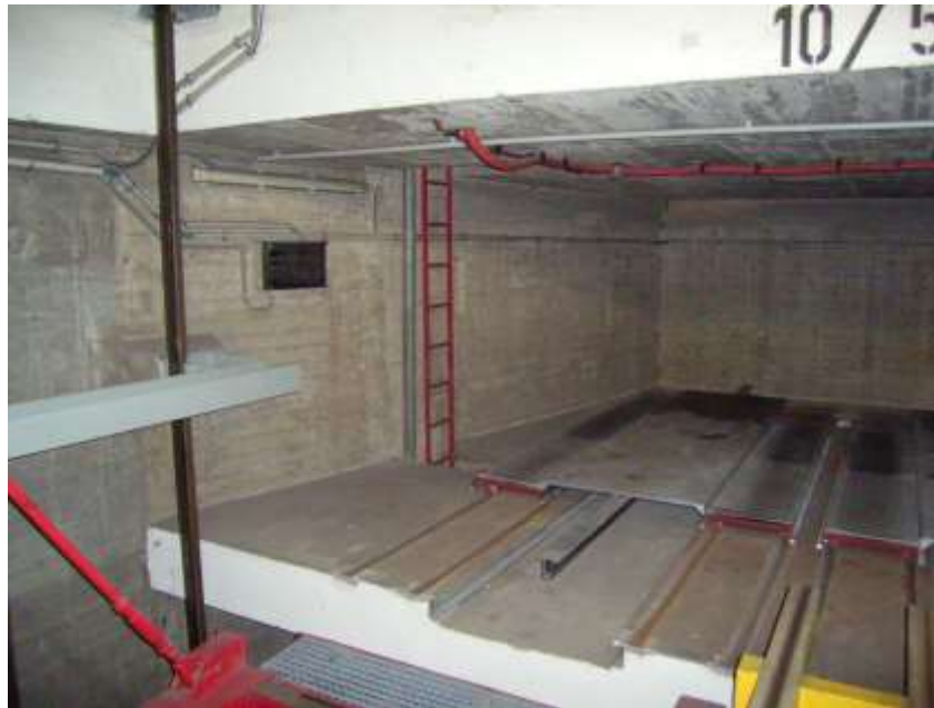
Bild 5 Steigleiter zur KFZ-Einstellebene
