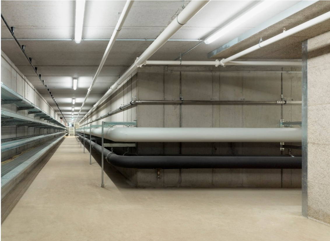
Bild 5 Unterirdischer Versorgungsgang mit einer Länge von 120 m (Quelle: HHS, Kassel)
